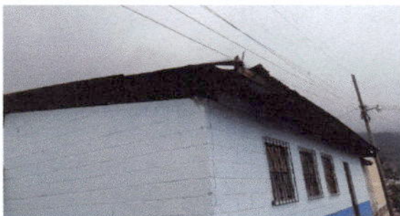
Foto 1: Filtración de agua en los techos.
